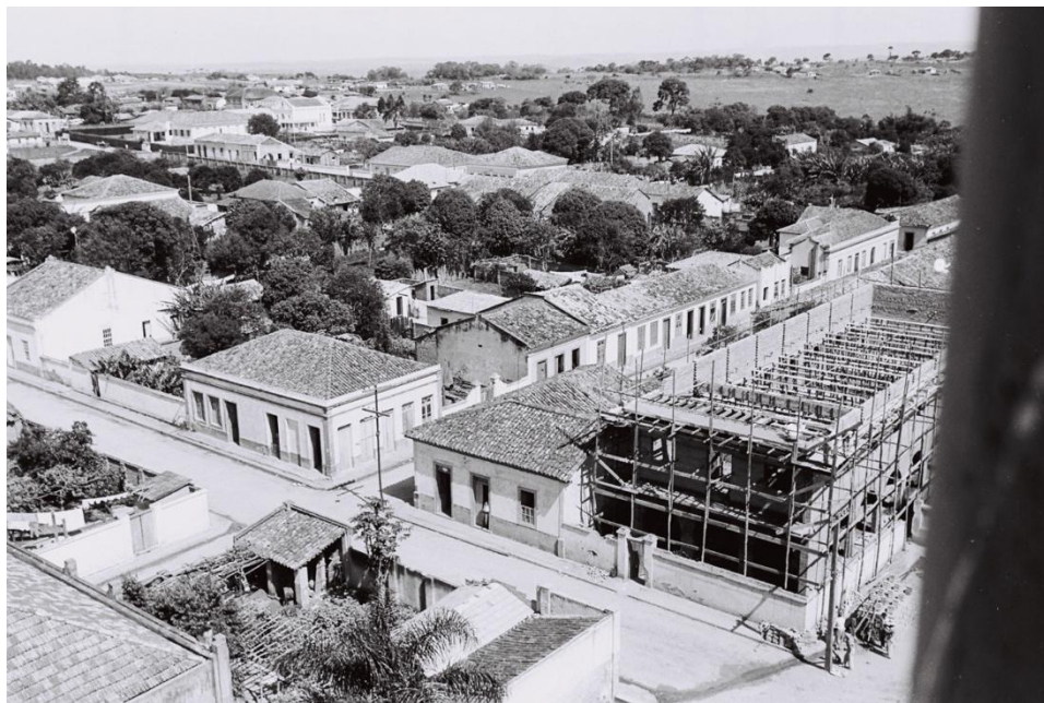
Obras do prédio na década de 1950, com visão das ruas 7 de setembro e Quintino Bocaiuva. Autor desconhecido. Acervo Assis.
