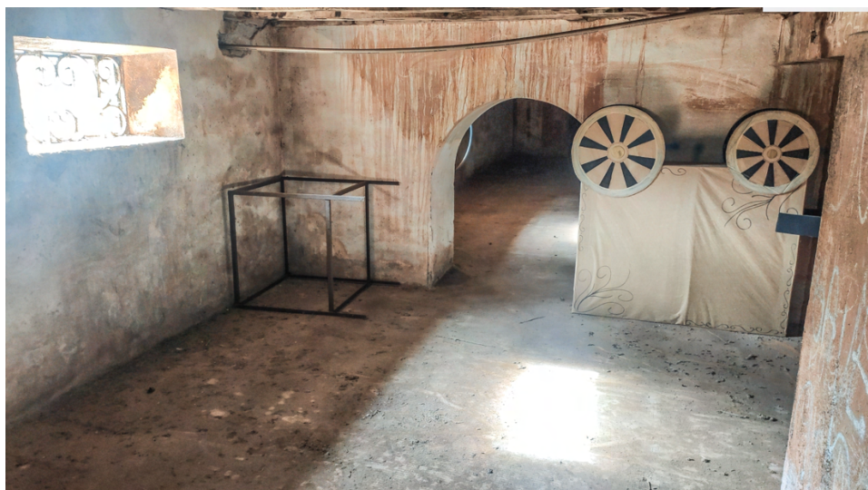
Imagem do porão da escola. Segundo relatos até algumas décadas atrás, havia inscrições nas paredes do porão, onde soldados da revolução se esconderam. Foto: Verônica Volpato, 2022.
